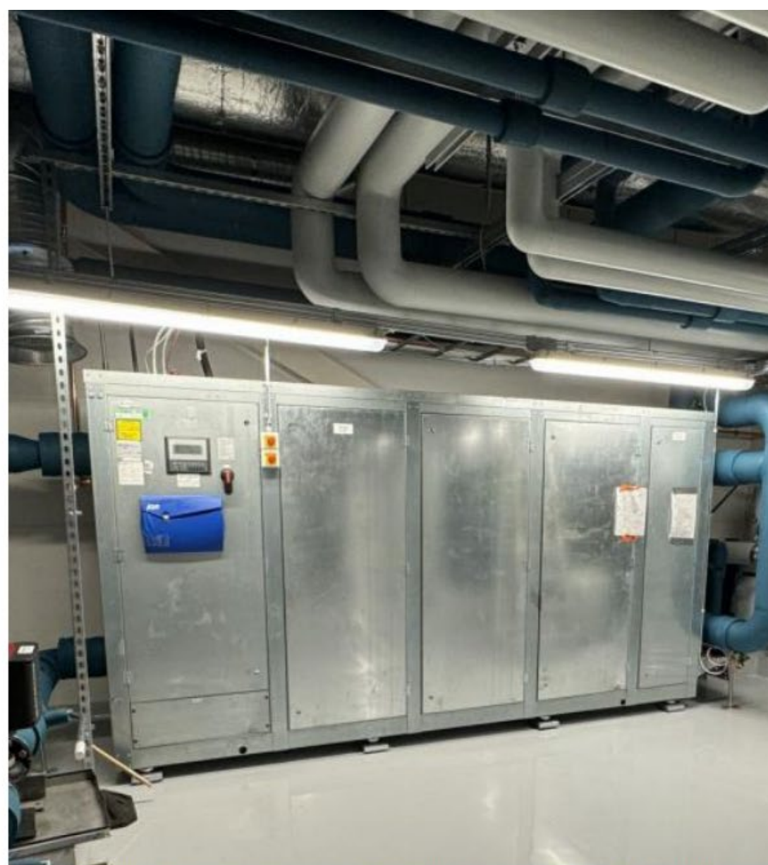
Kuva: Vedenjäähdytyskone asennettuna uudiskohteessa. (Lähde: Ärväs, 2024)
