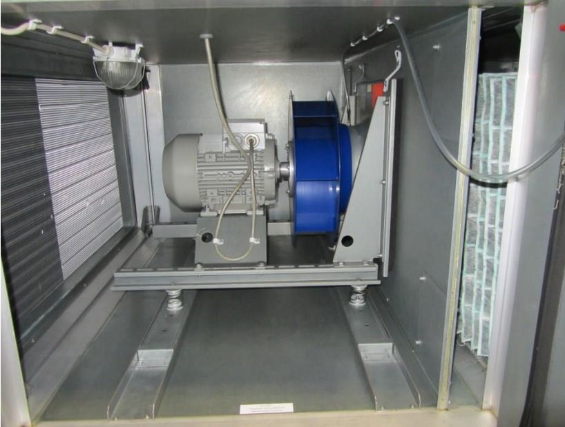
Kuva 3. Kaavuton puhallin. Tärinäeristimien kunto on yksi tarkastuskohde.
