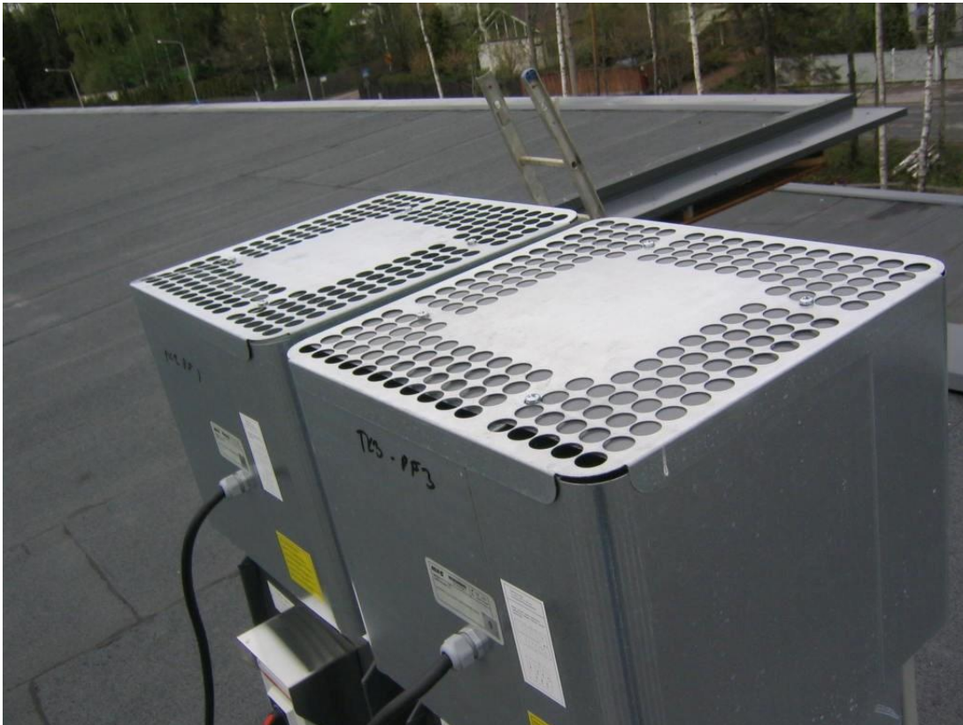
Kuva 5. Puhaltimien "kuristussäätö" ei ole oikea tapa ilmavirtojen säätöön.
